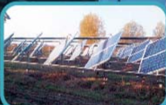
Impianto fotovoltaico a terra ad inseguitori solari. Argelato (Bo)
